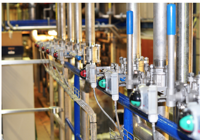
Ventiler fra DVC sidder mange steder i anlægget.
